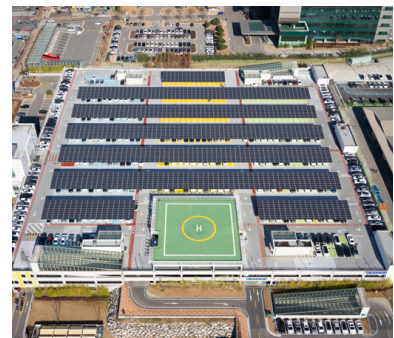
— 수원사업장 주차타워 옥상에 설치된 태양광 발전 설비
