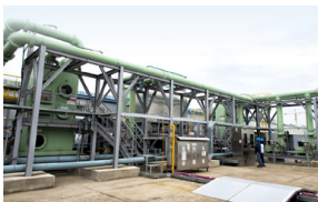
반도체 공정가스 처리 설비
